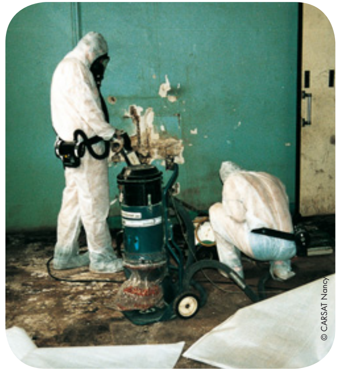
Décollement des dalles sous aspiration.
