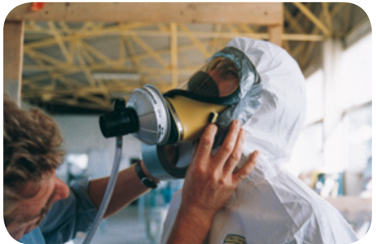
Avant l'entrée en zone, chaque opérateur fait vérifier l'étanchéité et le bon fonctionnement de son équipement par un autre opérateur (photo AFPA)
