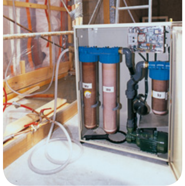
Ensemble de filtration d'eau.
