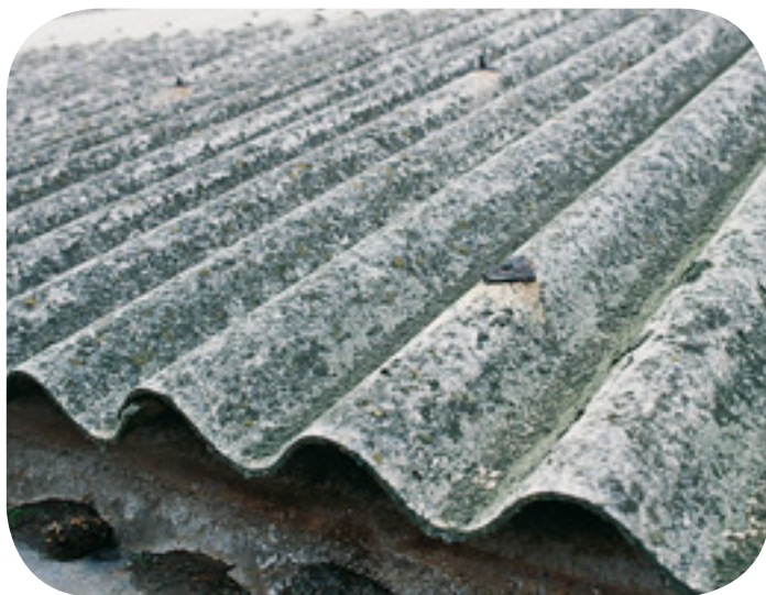
Toiture en amiante-ciment.
